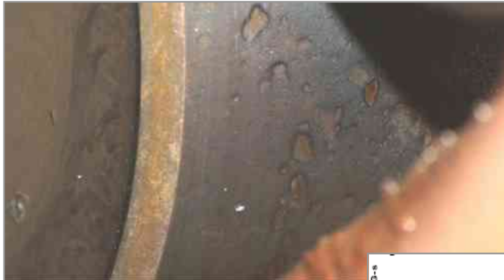
Foto 33: kamwals 2, lager noord boven; putten en corrosie op rolelemente
